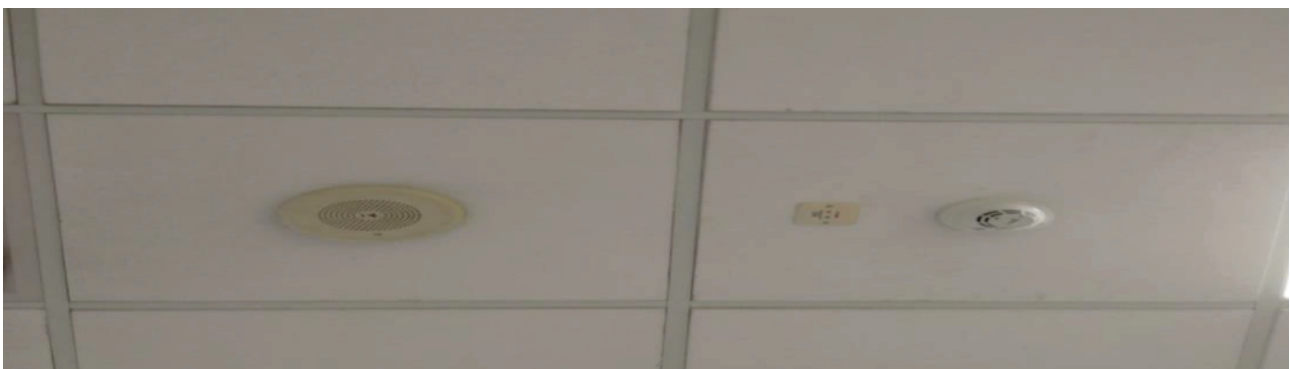
चित्र 7 : कम बिजली की खपत के लिए मोशन डिटेक्टर सेंसर प्रणाली का उपयोग किया गया है
